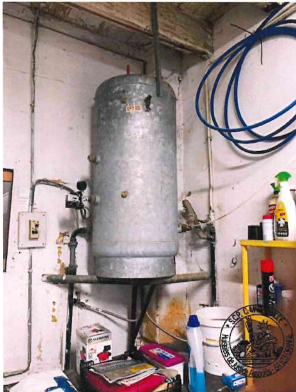
4. Ballon eau forage
