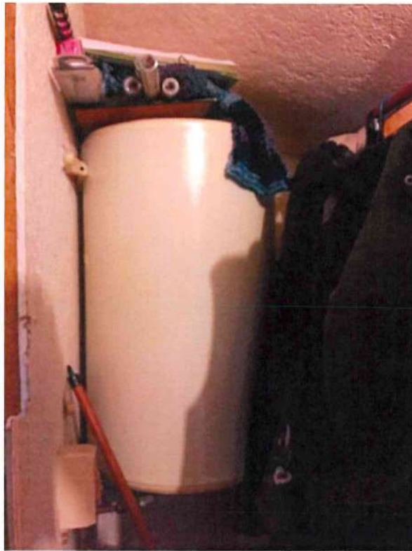
4. Cumulus électrique sous la montée d'escaliers
