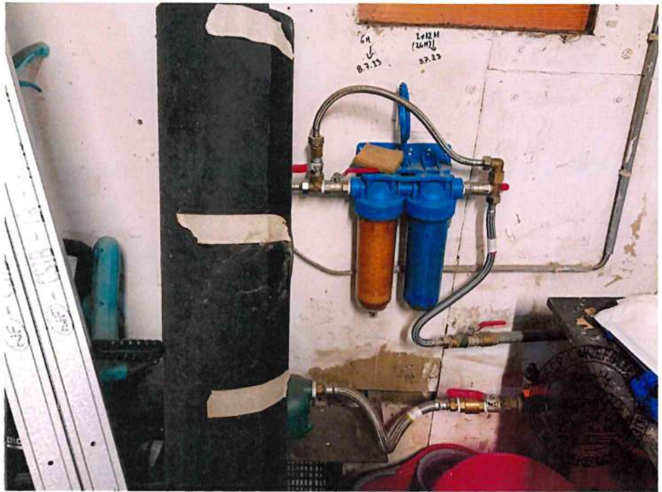
7. Groupe de filtrage
